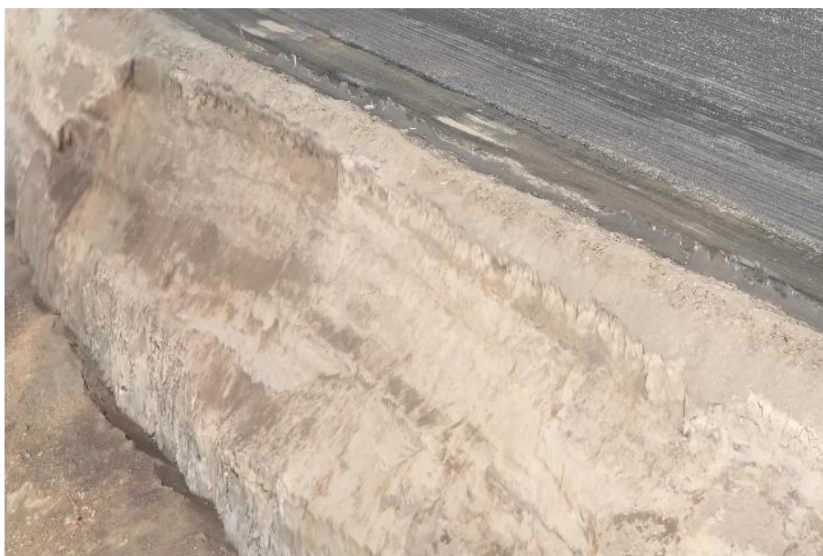
图 3-7 一采区北部顶部欠稳定粉质黏土边坡
