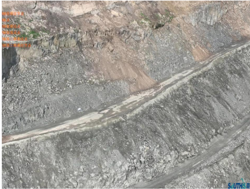
图 3-10 三采区开采崩落堆积的危岩体
